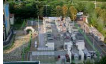
▲ 연료전지 발전시설 (안양열병합발전처)
