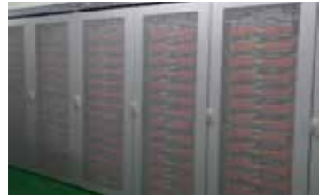
▲ ESS 발전시설 (안양열병합발전처)
