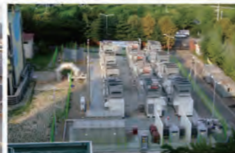
▲ 연료전지 발전시설 (안양열병합발전처)
