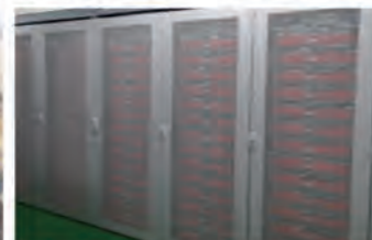
▲ ESS 발전시설 (안양열병합발전처)
