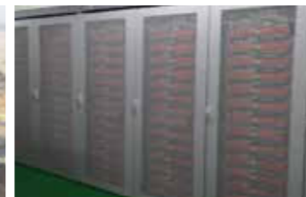
▲ ESS 발전시설 (안양열병합발전처)
