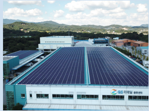
태양광발전시설 (GS리테일 물류센터)
