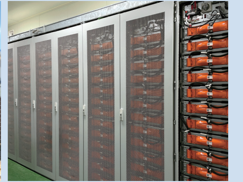
ESS 발전시설 (안양열병합발전소)
